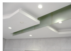
駒込データセンターのLED照明 (左右)
