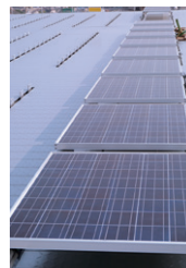
屋根の上に設置された太陽光パネル
