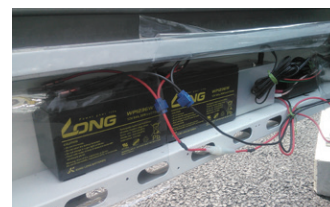
自動販売機内部に設置された災害時用搭載バッテリーと自動電源選択回路
