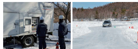
移動電源車による給電訓練
