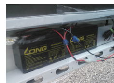
自動販売機内部に設置された災害時用搭載バッテリーと自動電源選択回路
