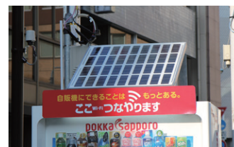
自動販売機上部に設置された太陽光発電パネル
